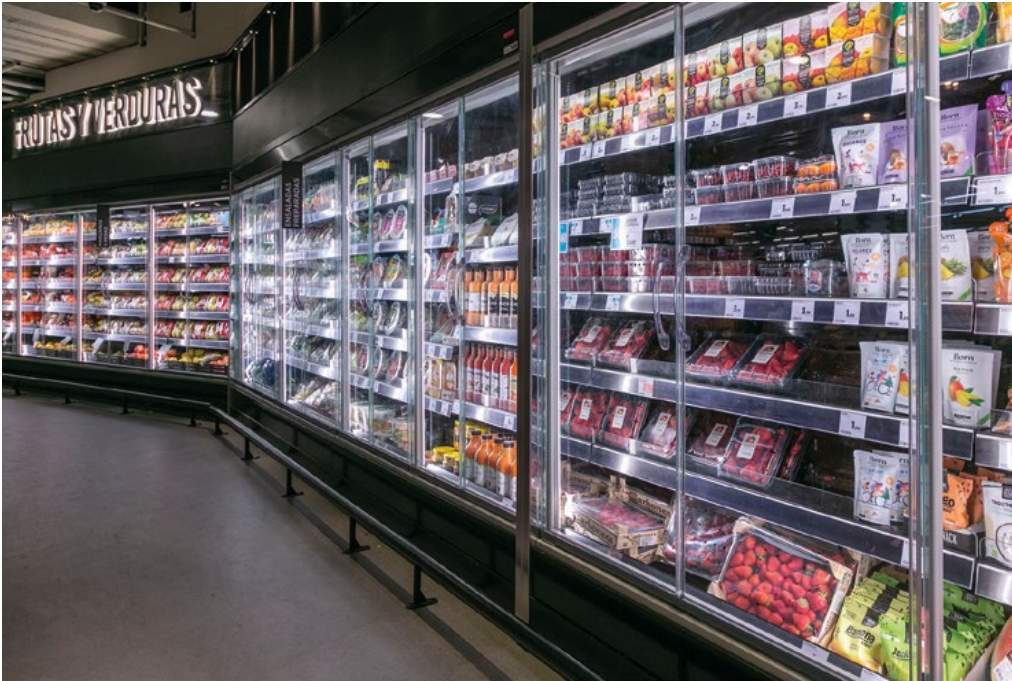
Ahorro energético: cerramiento de cámaras de frío en supermercado de El Corte Inglés de Pintor Sorolla, Valencia.
